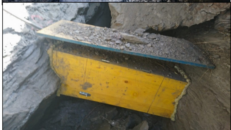
Abbildung 8: Einhausung der Konvergenzextensometer durch die WLW (Sommer 2019)
